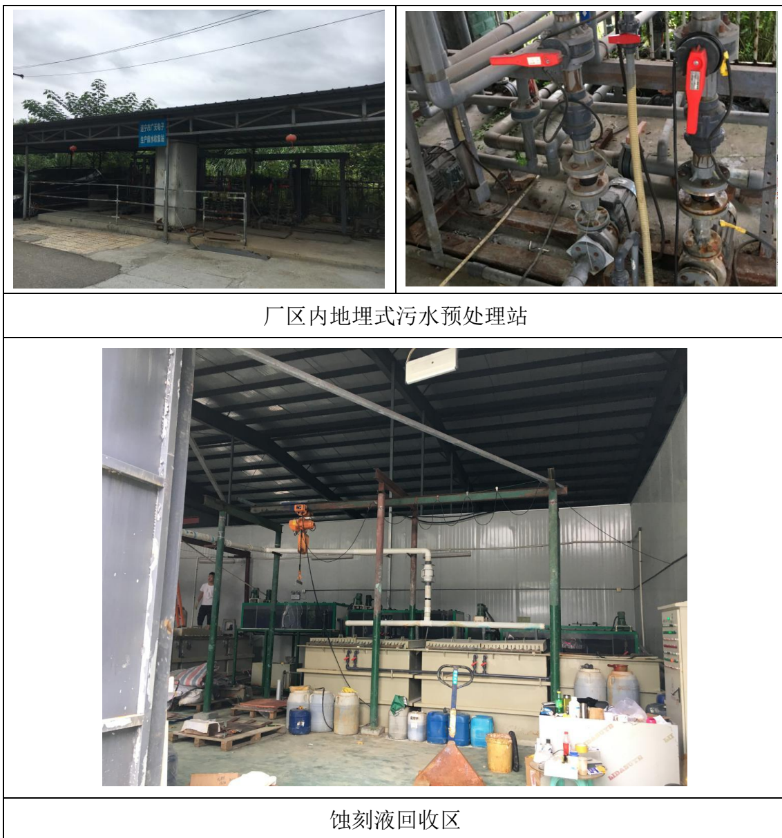
图 1.5-4 废水处理系统现场照片
