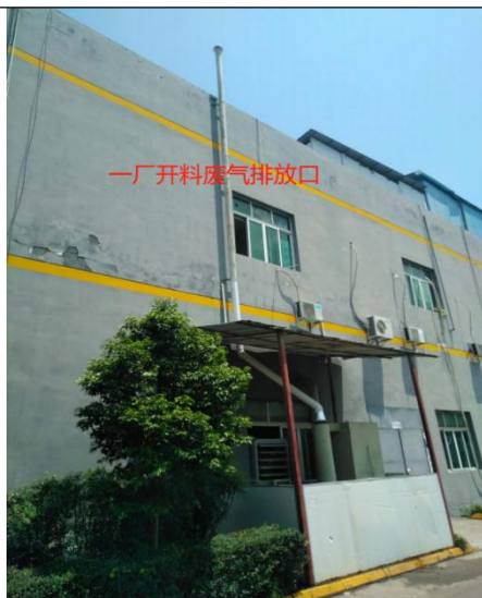
开料工序除尘器+15m排气筒
