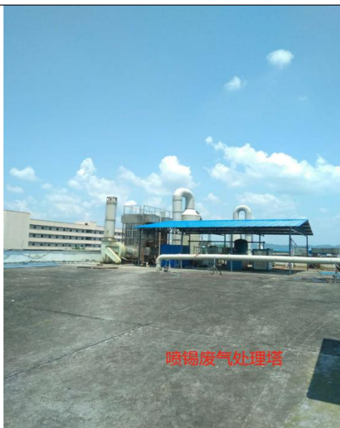
一厂喷锡废气排气筒
