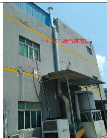
钻孔工序+15m排气筒
