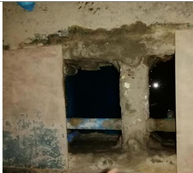
沉铜电镀废水收集池（一车间电镀生产线旁边）
