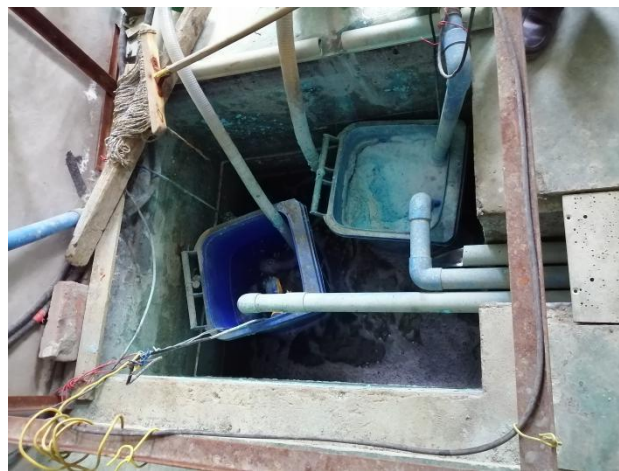
二车间生产废水收集池
