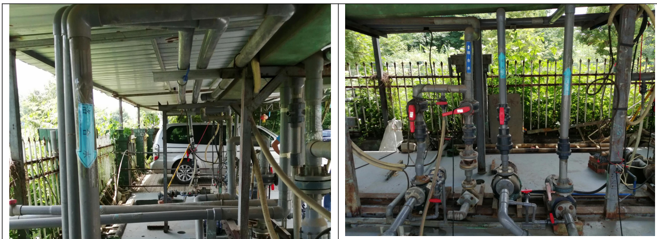
废水管道（污水处理站内）
