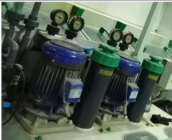
机械泵（表面处理车间）
