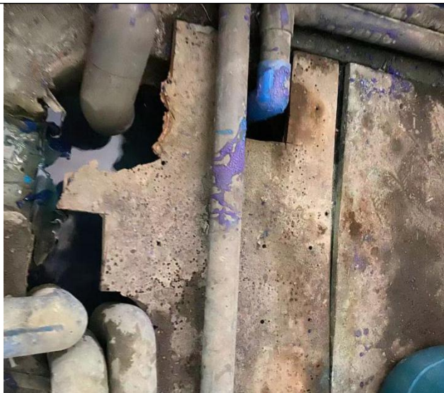
蚀刻线废水收集池（一车间电镀生产线旁边）
