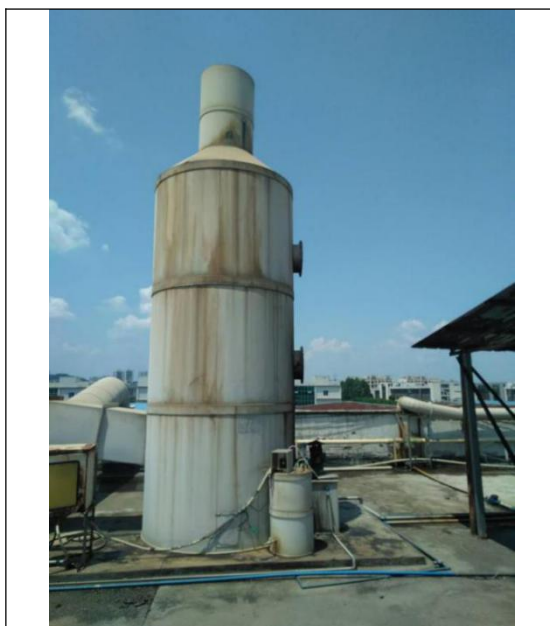
电镀线废气排放口
