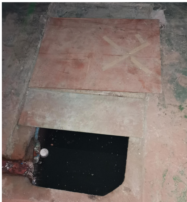
线路磨板线废水收集池
