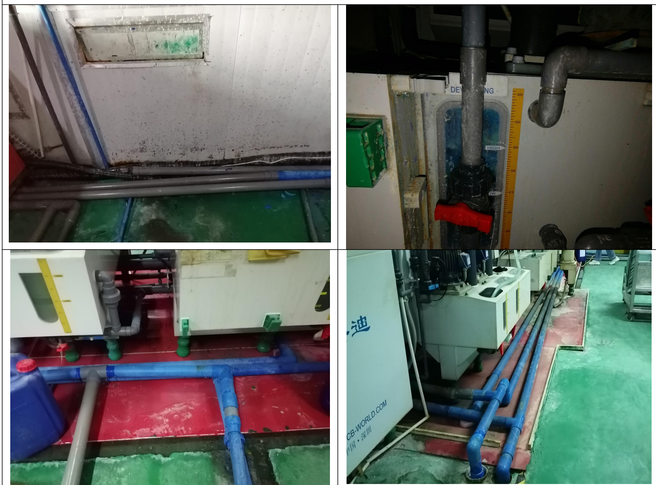
1#车间生产废水管道
